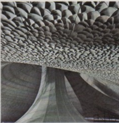
Die weiße Deckenhaut im Großen Saal Aus Chaos entsteht Wohlklang – die Oberfläche muss unregelmäßig sein, damit der Schall gestreut wird, erklärt Koren
